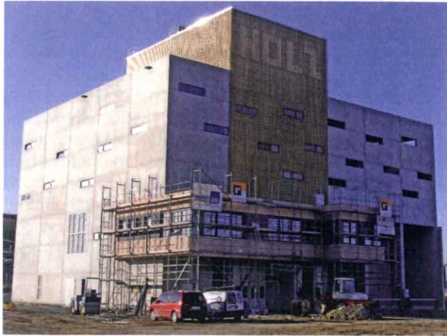
Kraftwerk in Designeroptik: Die Gestaltung des Holzheizkraftwerks greift das Thema Holz gleich zweifach auf und durchbricht damit die starre Betonfassade.
