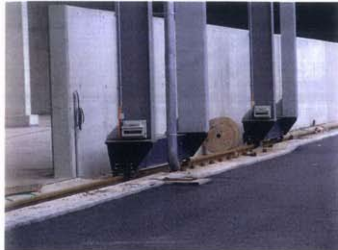
Bild 3. Die beweglichen Segmente des Gebäudes fahren auf einem Schienensystem; speziell entwickelte Schienenzangen sichern dabei die Halle gegen abhebbende Windlasten (Fotos: IBB Bönningheim)
